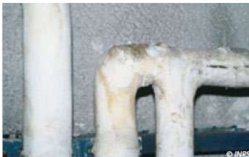
Calorifugeage de canalisations
